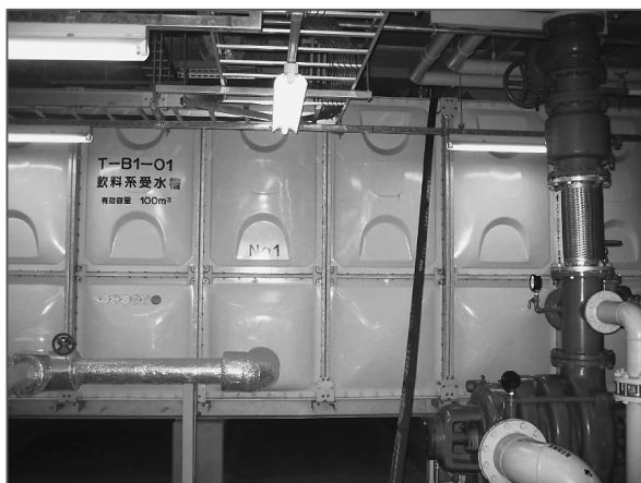
▲JRA福島競馬場FRP製貯水槽
